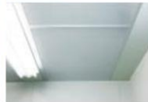
ルーム内吹出口施行例
