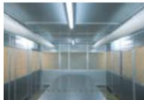
ルーム内吹出口施行例
